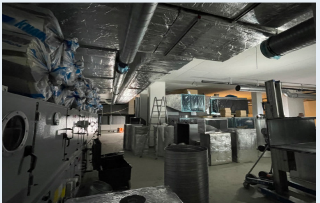
Einblick in die Lüftungszentrale
